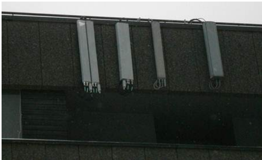
Foto 1: Bildet viser fra venstre LTE 800 (ikke satt i drift), LTE 2600, UMTS 2100 og GSM 900.
