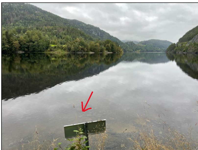
Figur 27: Døme på synleg sjøkabel som manglar overdekking ut frå landtak. Foto: Nkom
