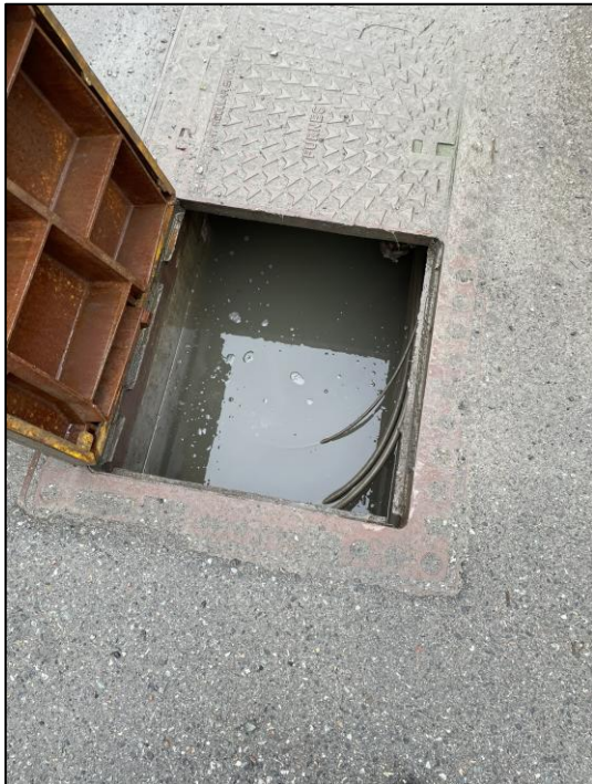
Figur 19: Kabelkum full av vatn ved sentral
