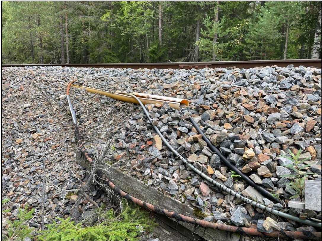
Figur 16: Kablar langs jernbanetrasé. Nokre av dei er utrangerte, andre skal vere i drift.
